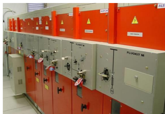
Figure 12 : Cellules électriques du poste de livraison
