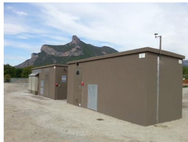
Figure 11 : Un poste de livraison et un poste de transformation
